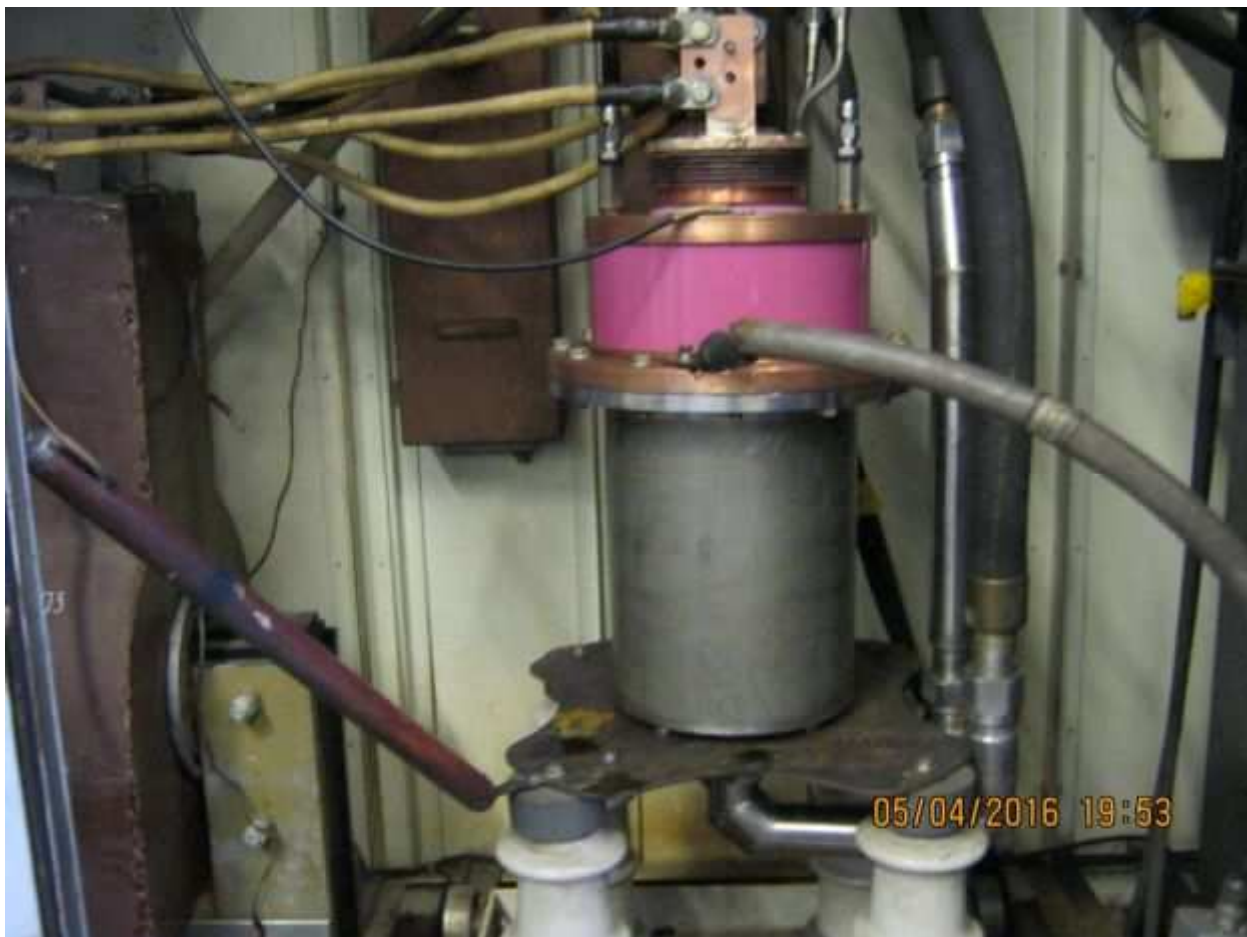
Рисунок 13 - Лампа ГИ-71АМ, установленная в модулятор.
